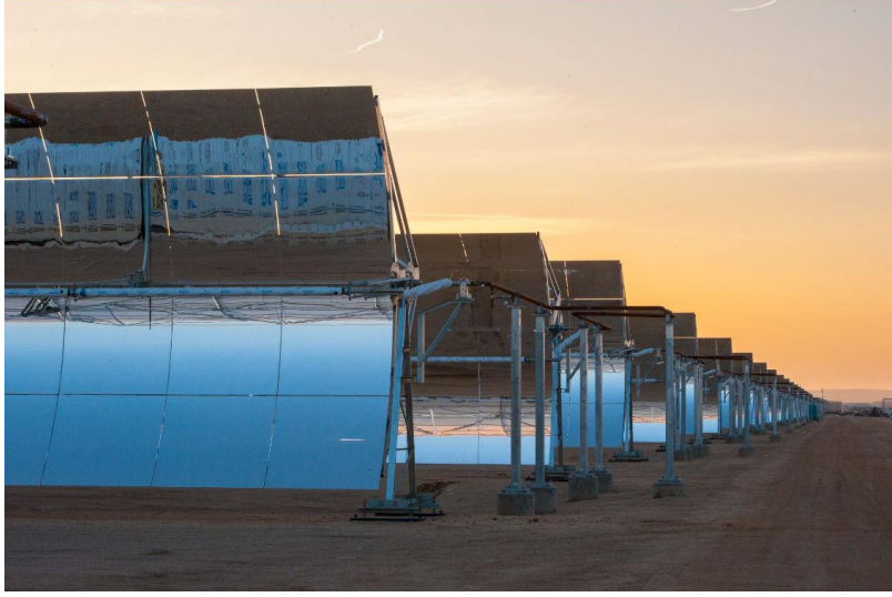
Görsel 8. ABD Mojave Solar Project, Parabolik Oluk Sistemi
