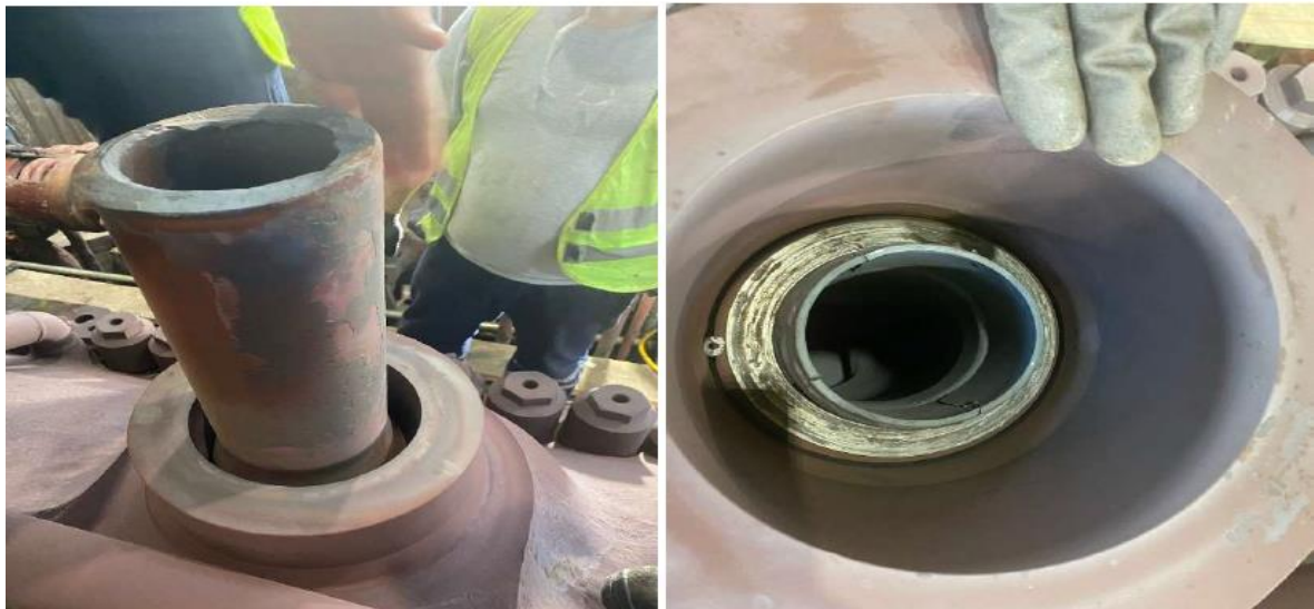
Görsel 3. Seyitömer TS, 3. Ünite Yüksek Basınç Türbini Girişi Anabuhar Boruları
