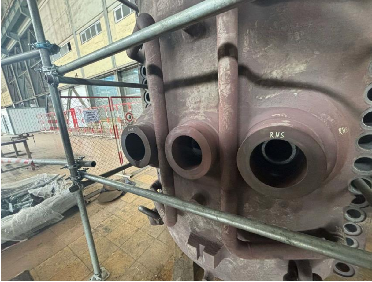
Görsel 4. Seyitömer TS, 3. Ünite Yüksek Basınç Türbini Gövde Anabuhar Giriş Bağlantı Boruları
